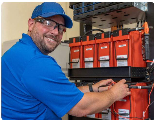
Membre de l'équipe Bell qui configure des groupes électrogènes de secours de manière proactive.
